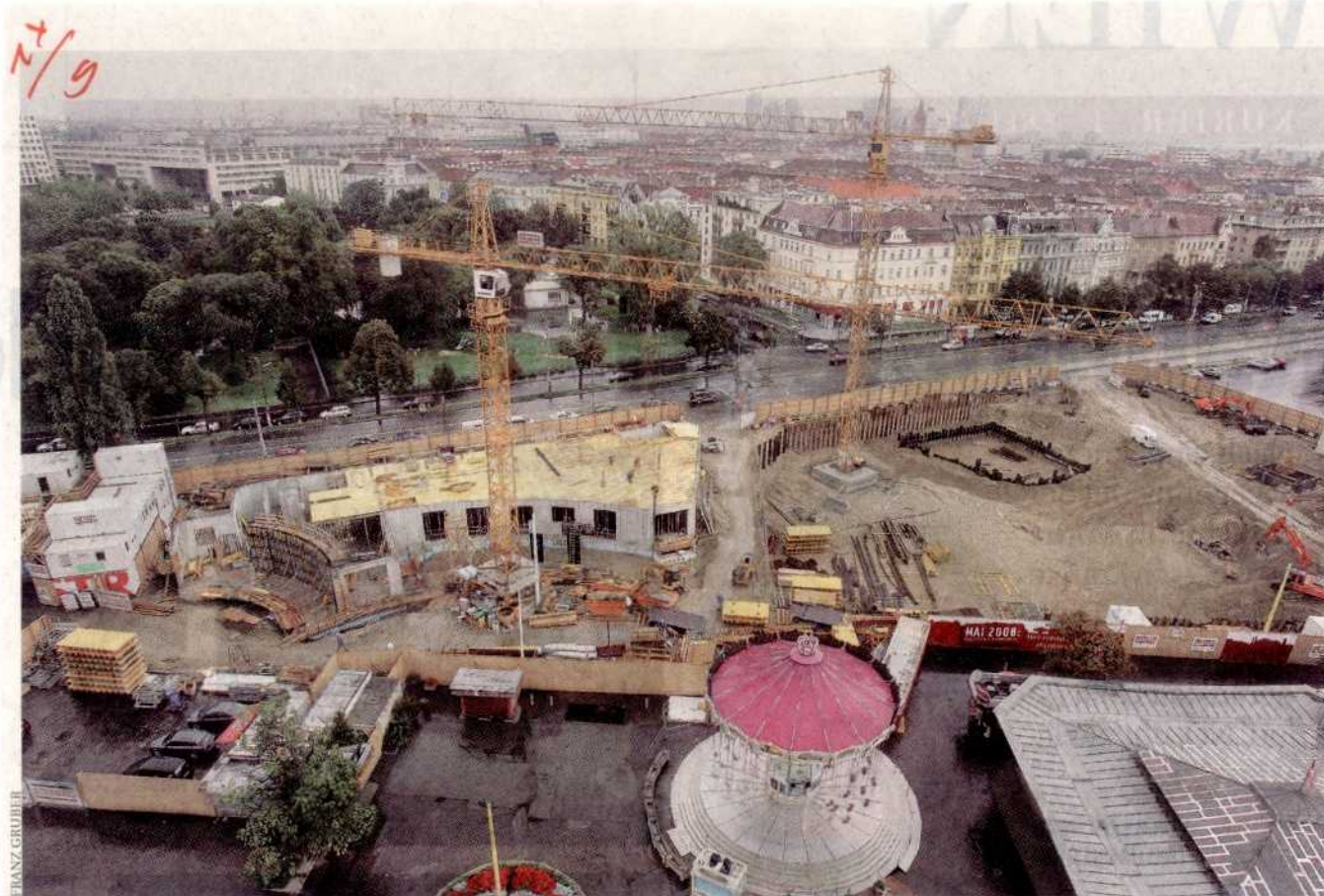
Baustelle Riesenrad-Platz: Bis 1. Mai 2008 muss das 37-Millionen-Projekt fertig sein. Die drei Alt-Wien-Gebäude werden acht Meter hoch
