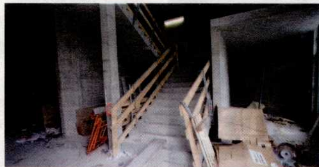
Bauschutt: Blick in das Innere eines der Bauteile am Vorplatz.
