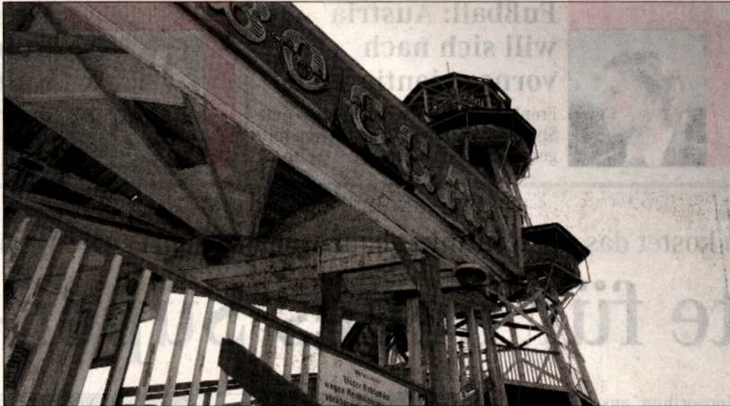
Wegen Verfalls seit sechs Jahren gesperrt: der hölzerne „Toboggan“. Foto: Jakob Glaser
