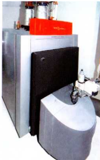
Die Wärmeversorgung im RiesenRäderwerk übernimmt ein Viessmann Vitoplex mit 170 kW Leistung.
